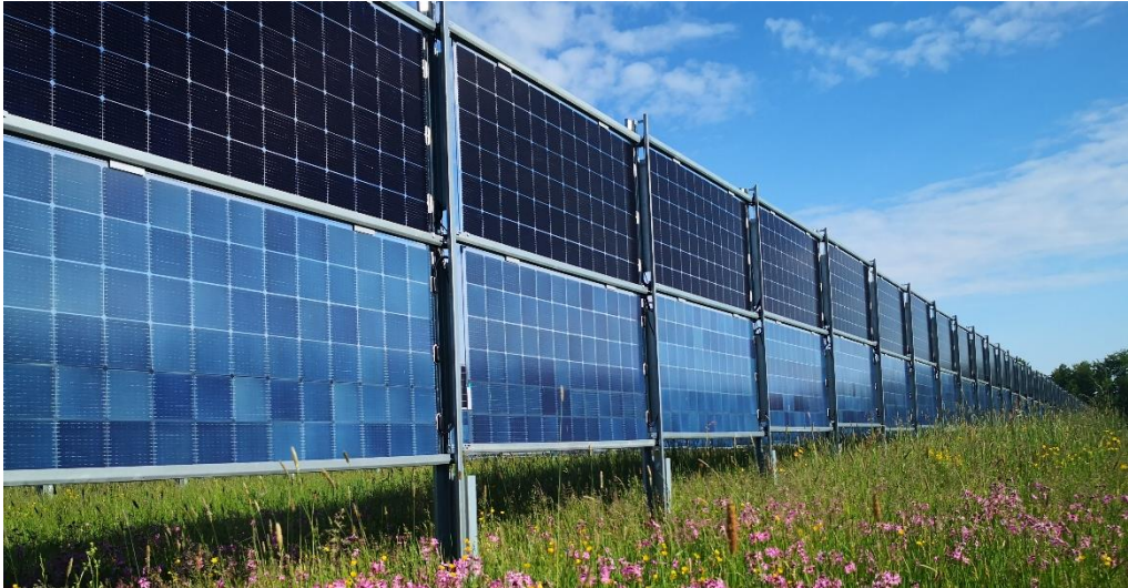
Abbildung 6: Beispiel für senkrecht errichtete Modulreihen (Quelle: Kundenmaterial)
