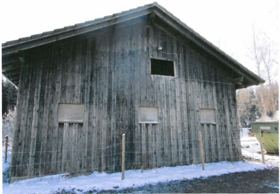
Abb. A3: Blick auf die Westseite des Stalls. Durch die Fensteröffnung sind Ei- und Ausflugmöglichkeiten für Vögel und Fledermäuse gegeben. Der Blick durch das Fernglas zeigte Kotspuren auf den Dachinnenbalken.
