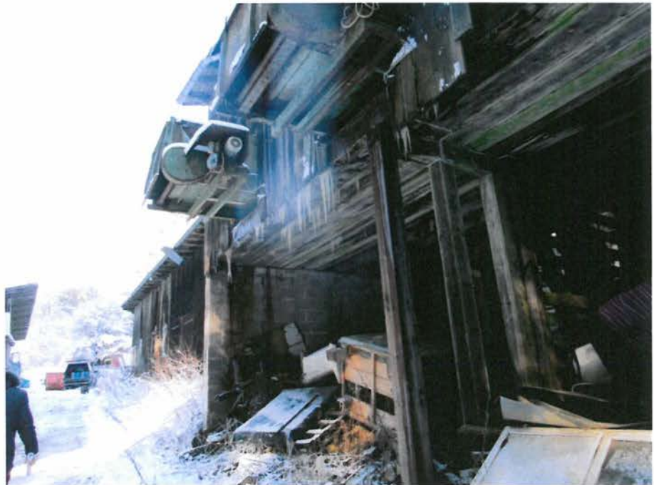
Abb. A6: Teilbereiche des Sägewerks sind eingestürzt und vermüllt.
