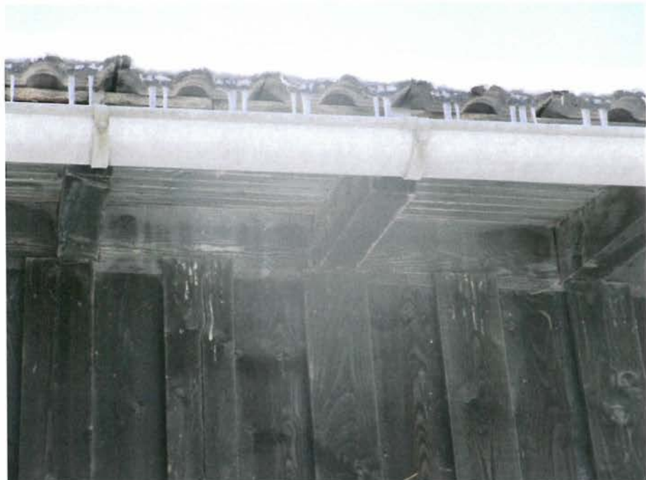
Abb. A2: Unterhalb des Dachs sind zahlreiche Kotspuren. Unterhalb der Dachziegel sind Hohlräume gegeben.
